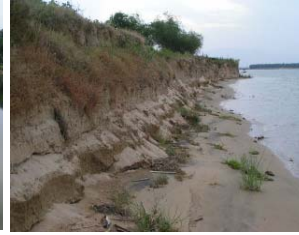
A3. Xói lở trên đoạn bờ hữu dài 3km ở thôn An Hà, Thôn Thi Phương và Thôn Cẩm Phú - Điện Phong. (5/2005)
