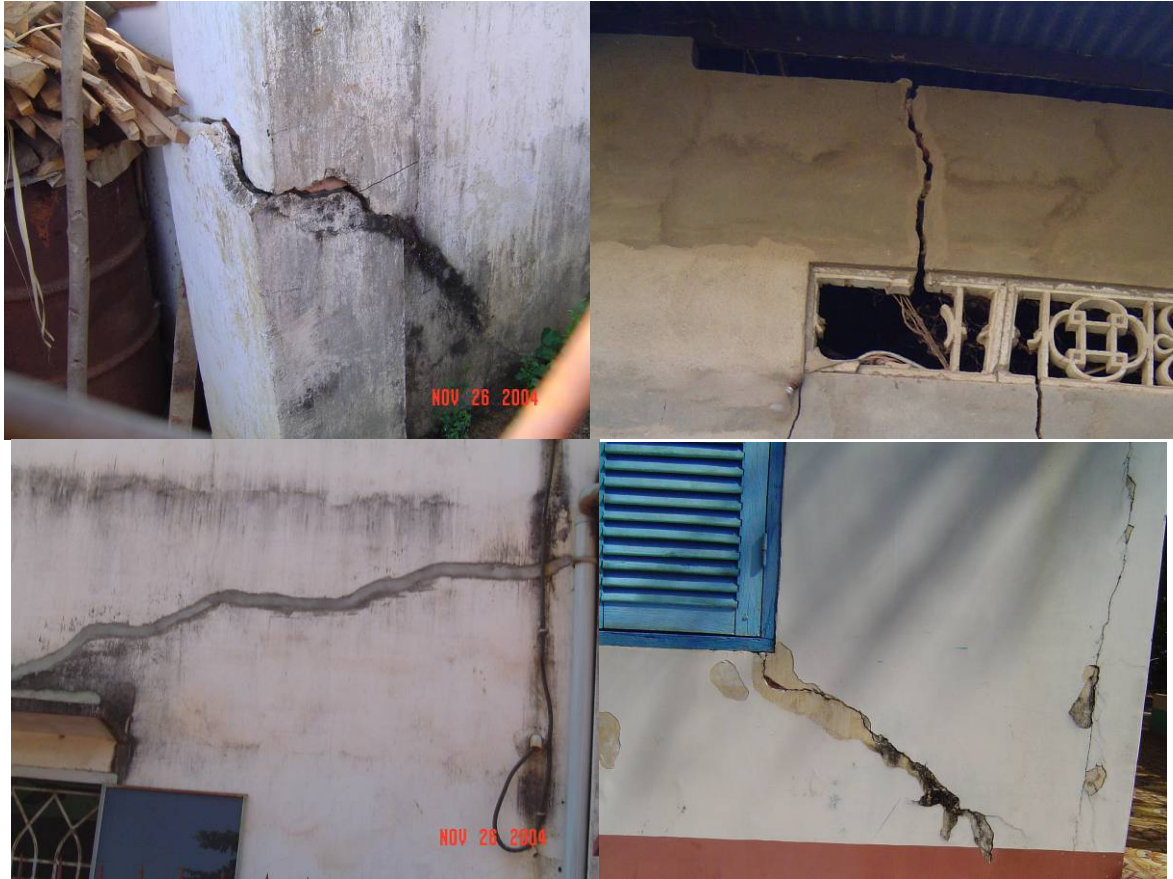
Hình 1: Hình ảnh các nhà dân dụng bị nứt ở khu vực áp Lộ Đức 2
