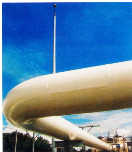
Hình 2: Tuyến ống vận chuyển khí đặt trên mặt đất
