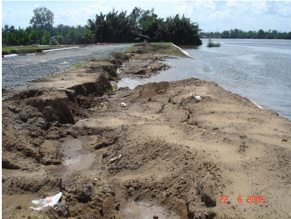
Hình 8: ... sạt lở đã xảy ra (Sạt lở bờ hữu sông Sài Gòn – khu vực bán đảo Thanh Đa – đối diện bãi contenno nhà máy Đông Ah – Thủ Đức)
